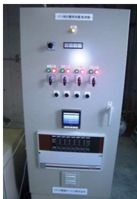
写真2 ガス測定装置操作盤
