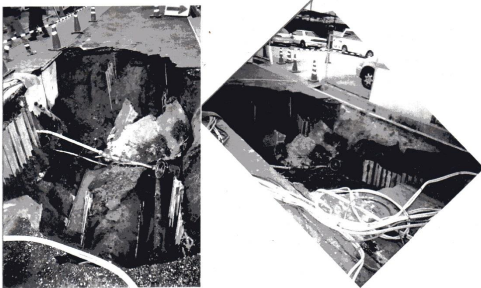
路面陥没状況
